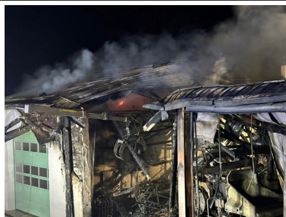
B3 Vollbrand einer Maschinenhalle
